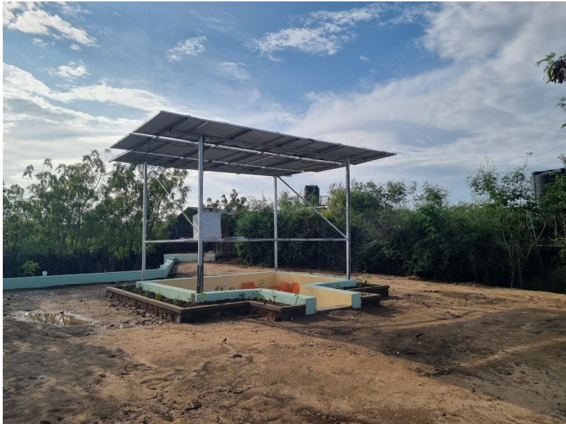
Fig 1(a): Solarbetriebene Wassergewinnung aus dem Waso-Fluss. 12 Solarmodule mit je 4.800 Watt Leistung. Das reicht aus, um 15 Kubikmeter Wasser pro Stunde in eine Entfernung von 10 km zu pumpen, was 15.000 Litern Wasser entspricht. Das Dorf Umoja ist nur 1 km von der Wasserquelle des Systems entfernt.
