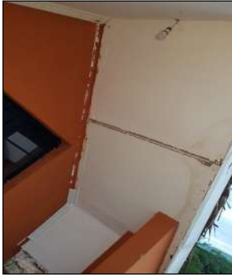
Bild 13: Zerstörte Gipsdecke auf der Veranda eines neu renovierten Bandas
