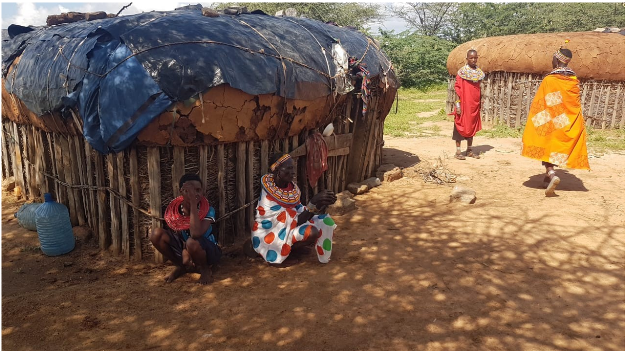
Fotos vom Zustand der Wohnhütten
