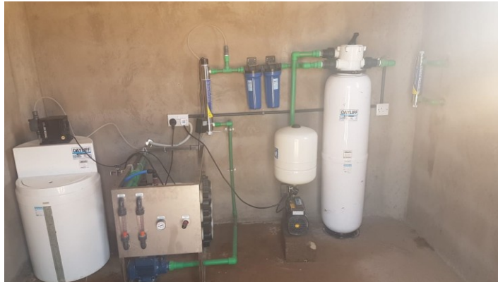
Fig 3: Entsalzungsanlage installiert und betriebsbereit
